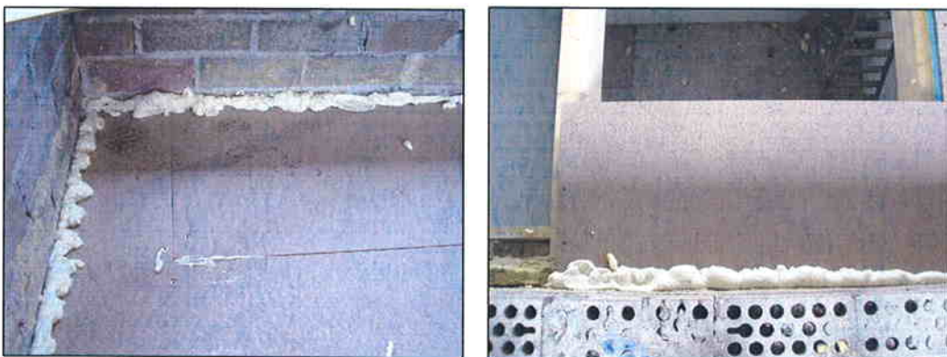
Fotografías 10 y 11 Sellado de la unión entre los paneles Thermochip y el muro
